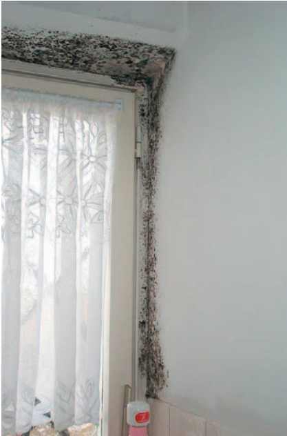
Schimmelpilzbefall nach einem Wasserschaden. Schimmelpilze sind nicht nur ein ästhetisches, sondern auch ein gesundheitliches Problem!
